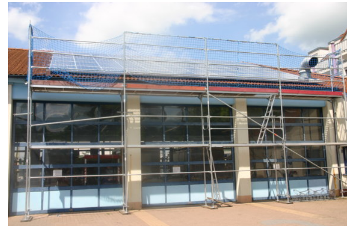
VG-eigene PV-Anlage auf der Feuerwache
