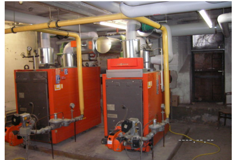
Heizungsanlage der GS Wörrstadt
