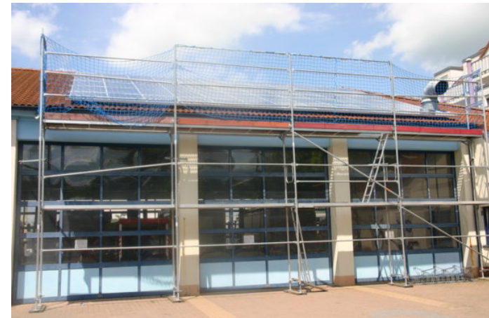
VG-eigene PV-Anlage auf der Feuerwache
